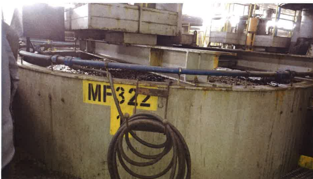
Foto 1. Widok ogólny części naziemnej maszyny flotacyjnej.
